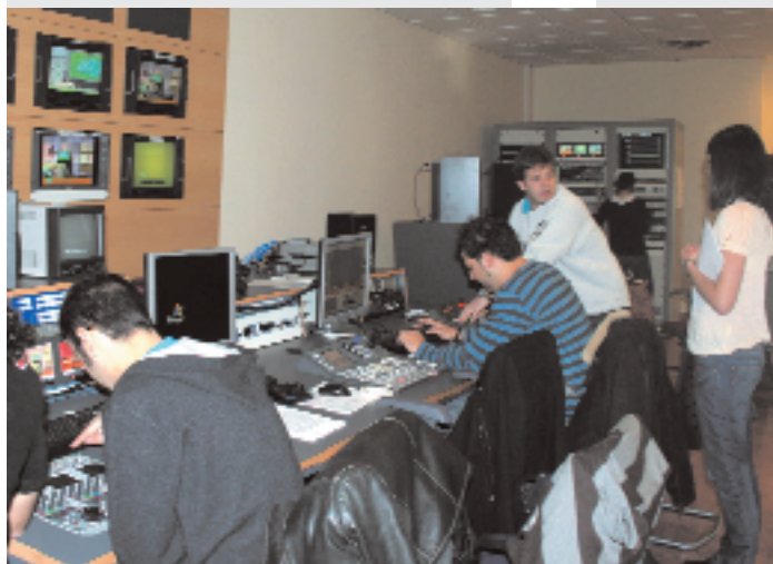
Sala de control de realización de televisión del Centro Integrado Formación Profesional de Comunicación, Imagen y Sonido de Langreo
